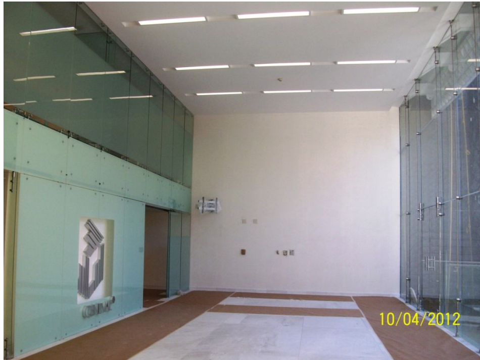
Plafón en tabla roca, cancelería en vidrio, pisos en mármol
