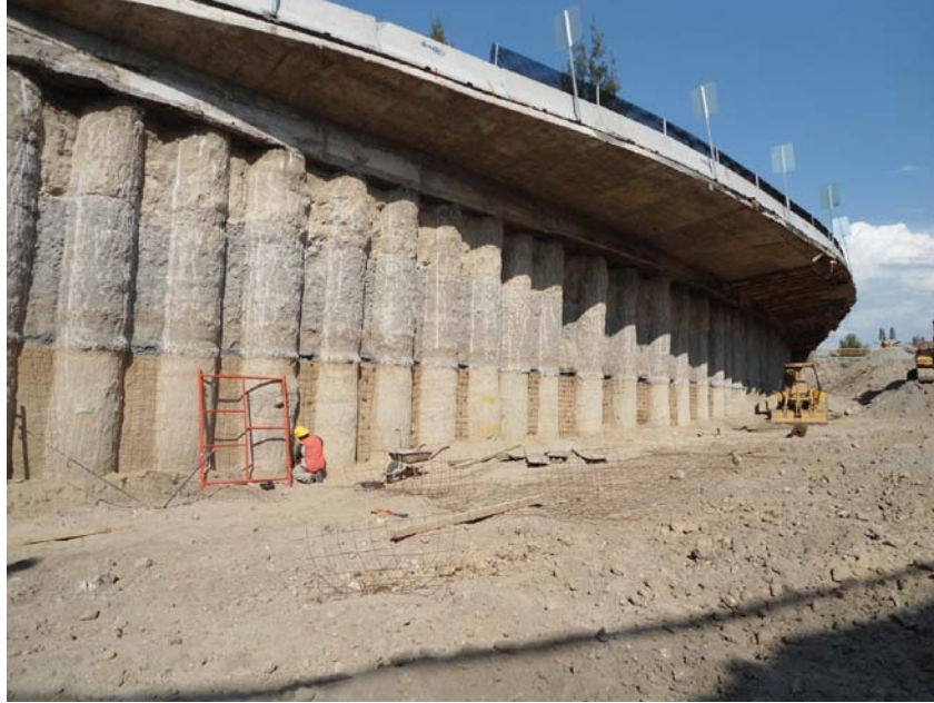
Figura 2.19 Rugosidad en pilas perforadas en rellenos, lahares y tobas (Foto cortesía de Ing. Raúl Verduzco)
