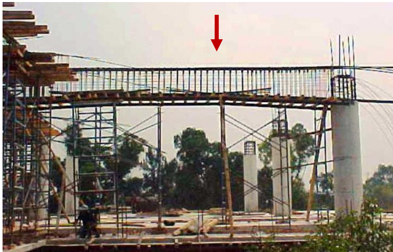
Figura 2.9 Detallado deficiente en la zona del vértice
