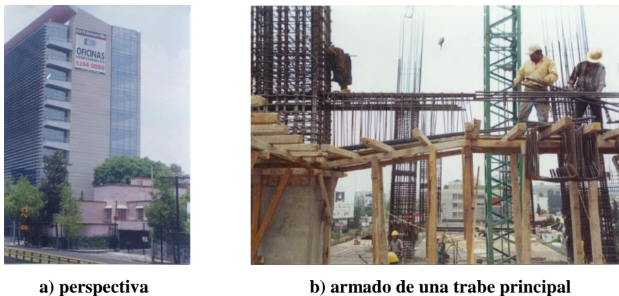
Figura 8.56 Edificio con trabes acarteladas en la zona de terreno firme de la ciudad de México
