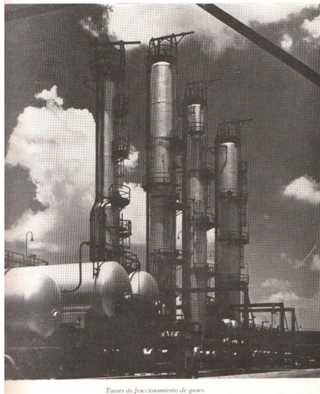
Torres de fraccionamiento de gases.
