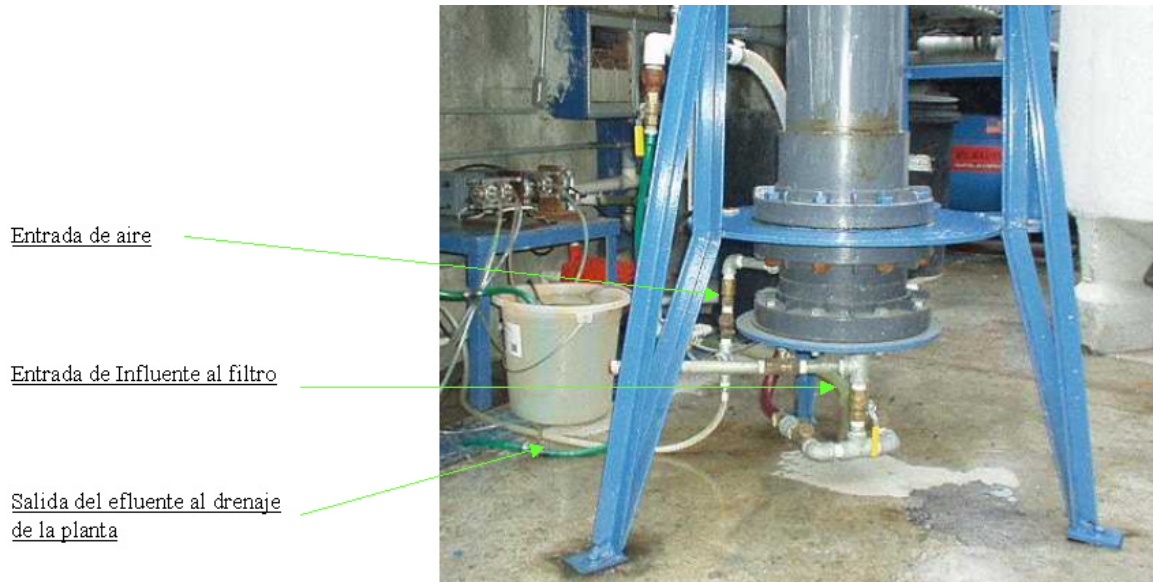
Figura 3.3. Parte baja del filtro piloto
