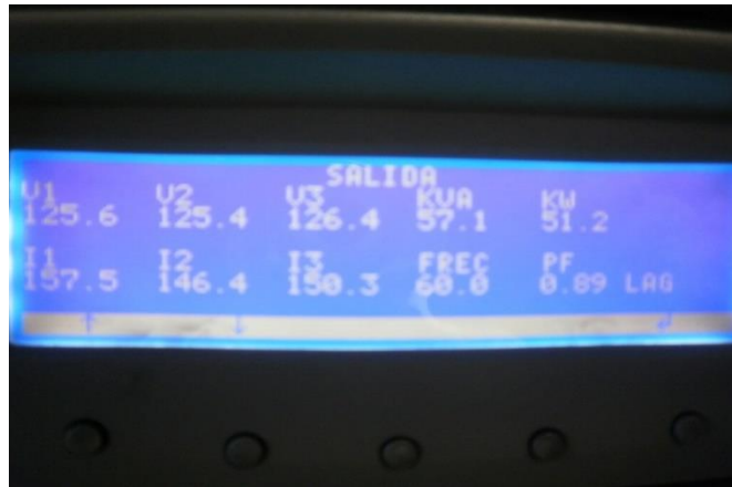
Figura 2.7 Datos de Salida del Sistema de Alimentación Ininterrumpida.
