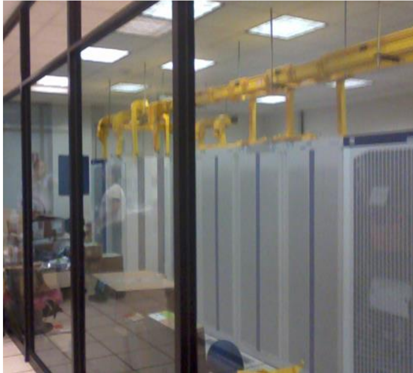
Figura 2.6 Vista del Equipo Electrónico en el Centro de Procesamiento de Datos.
