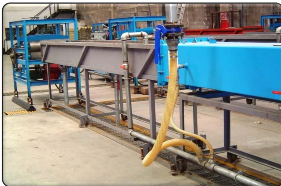
Fig. 3.8. Vista lateral de la conexión entre el formador y la tina de enfriamiento.
