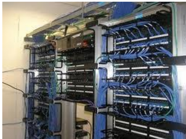
Figura 2.7. Cuarto de telecomunicaciones.
