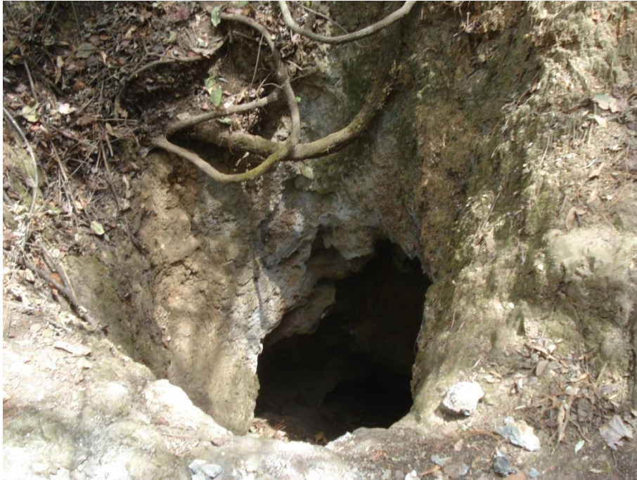
Fotografía 12: Vista general se aprecian las dimensiones del socavón de Arroyo Cuentla.
