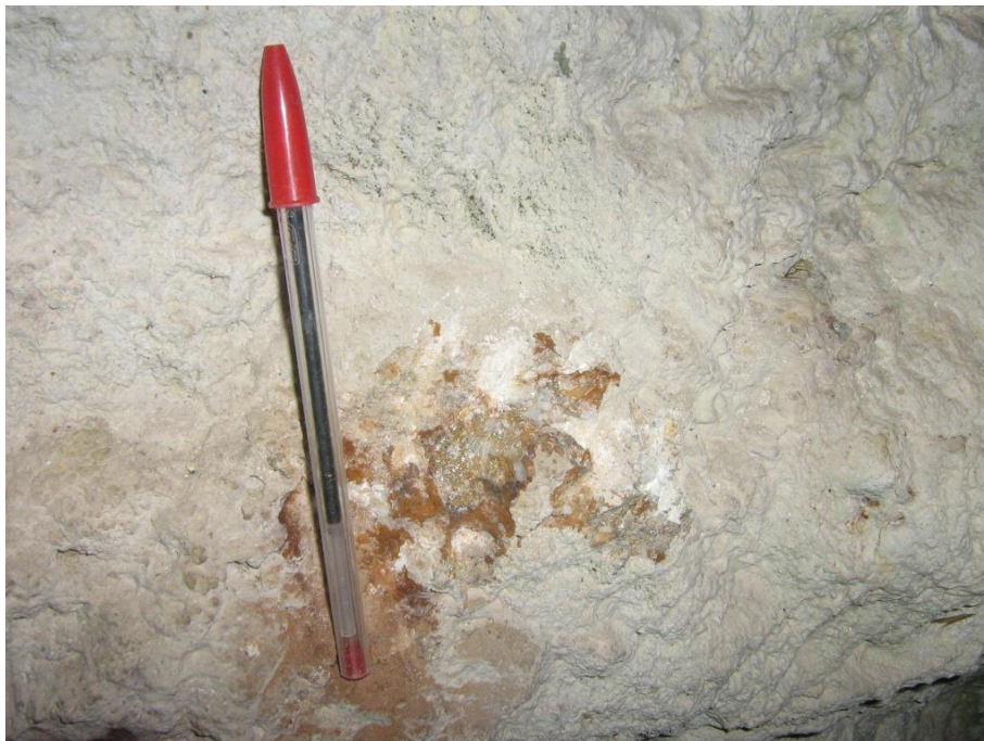
Fotografía 57: Detalle de los sulfuros presentes en la cata junto con la capa carbonatosa que cubre a las rocas
