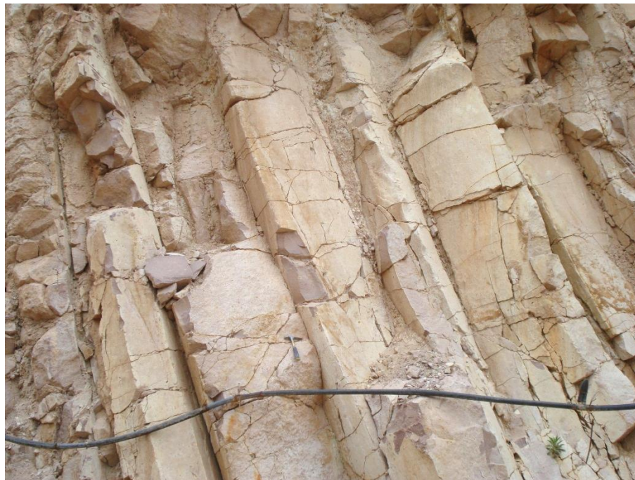
Fotografía 76: Vista a detalle del banco de riolita de Ahuacatlán municipio de Ixtapan de la Sal donde se pueden ver el fracturamiento que presenta el banco.
