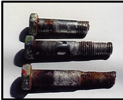
Fig.2.12: Falla por corrosión general en tornillos [IDDP].
