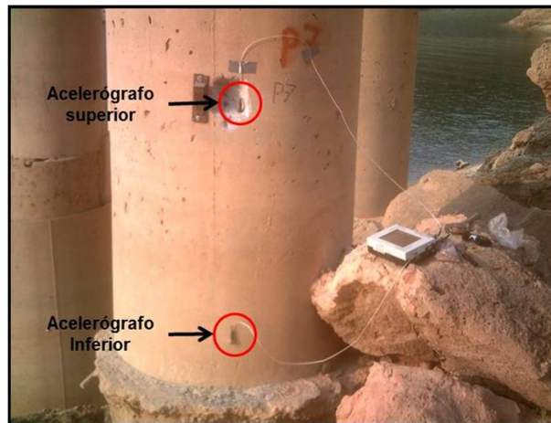
Figura 12. Acelerógrafos instalados en la cara expuesta de la pila.
