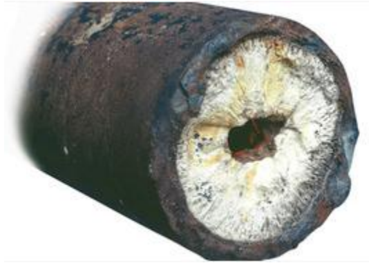
Figura 5. Tubo con incrustaciones minerales.
