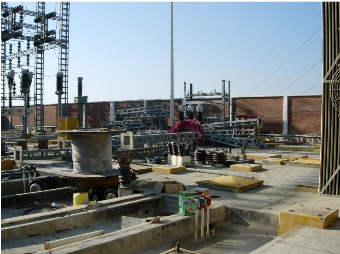
Foto que muestra la estructura existente en proceso de retiro y obra civil por demoler.-
