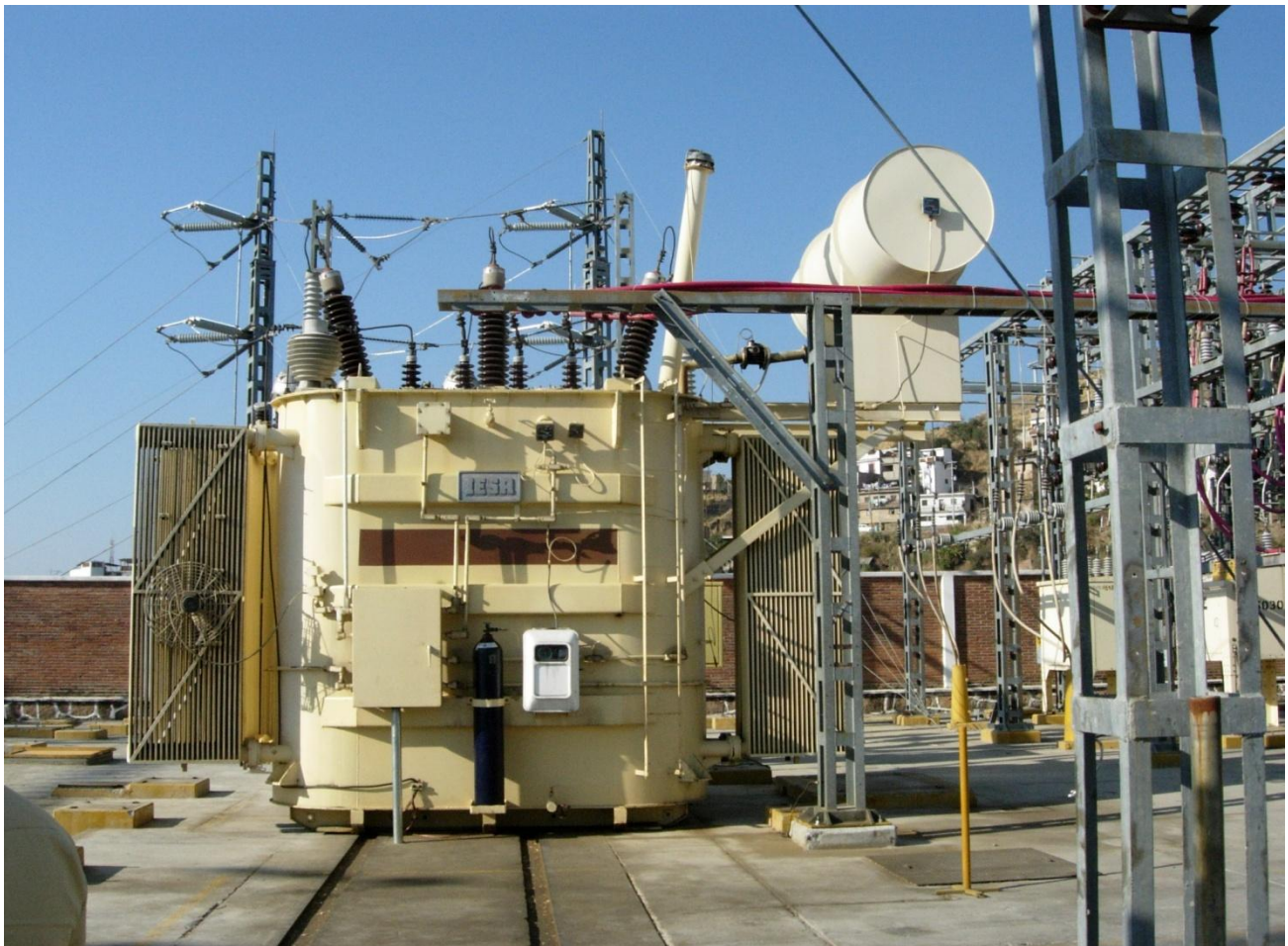
Transformador existente y sus conexiones provisionales. Año de Fabricación, 1985.
