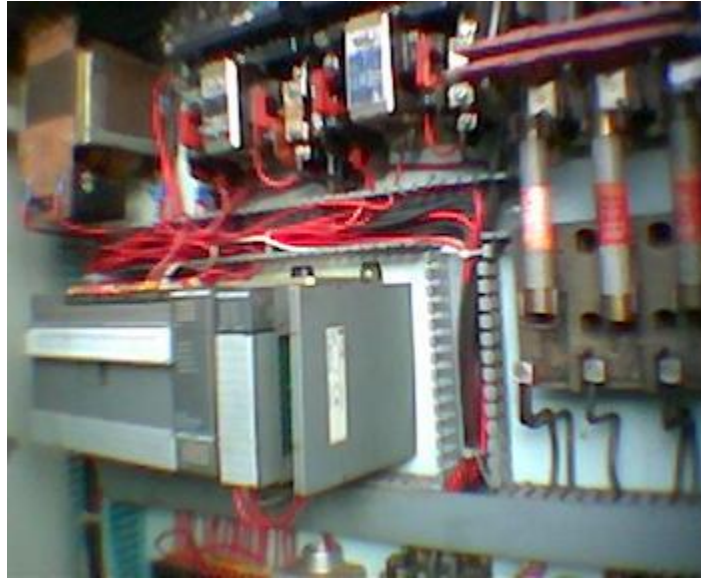
Sistema de control con PLC, arrancadores y fusibles de protección
