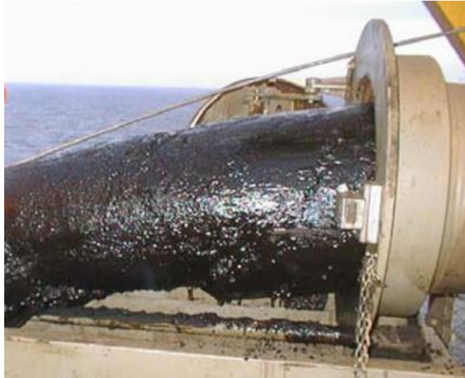
FUENTE: www.hydrafact.com/technical_services_wax_asphaltene.html FIGURA 5.5, "DEPOSITACIÓN DE CERA DENTRO DE LA TUBERÍA"
