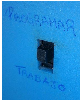
Figura 5.11.- Switch enclavado de programación. [23]
