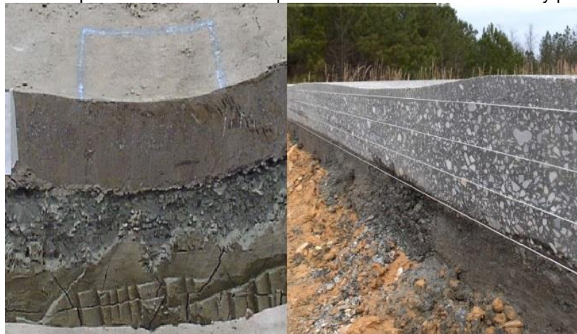
Figura 1.9 Comparación entre fallas en pavimento flexible convencional y perpetuo.
