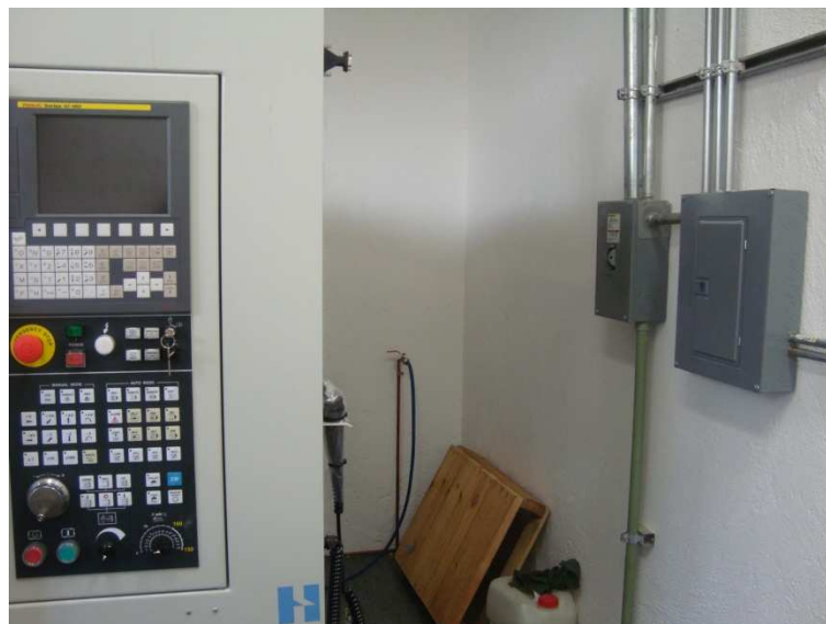
Figura 2. Ubicación de la llave de aire comprimido y perilla de corriente eléctrica.
