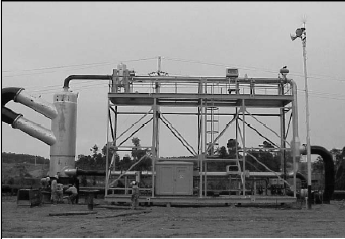
Fig. 3.1 Sistema de medición-separación con un CCGL en Minas, Indonesia.
