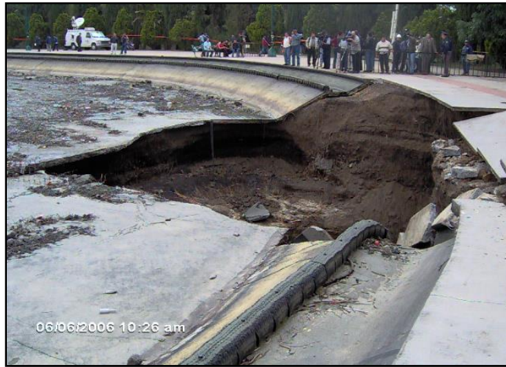
Fotografía 1.- en junio de 2006 a raíz del colapso en la cimentación de la estructura del lago mayor se ocasiono un boquete en el subsuelo que erosiono y socavo los primeros metros.*
