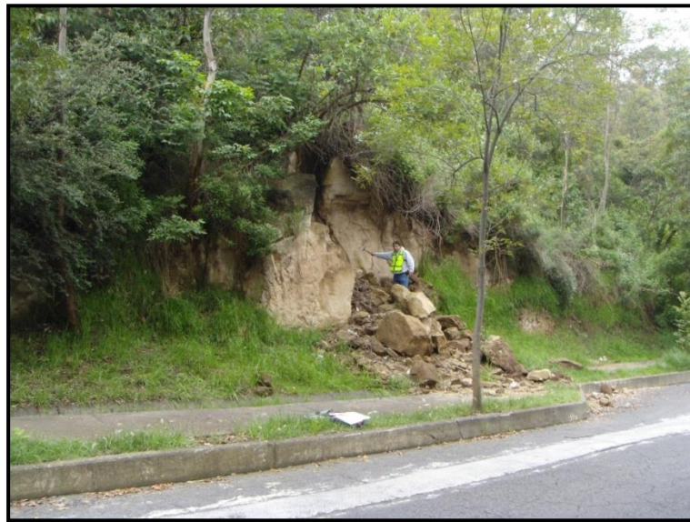
Fotografía 4: se muestran los bloques desprendidos del talud “caídos”, y un posible plano de deslizamiento del material.
