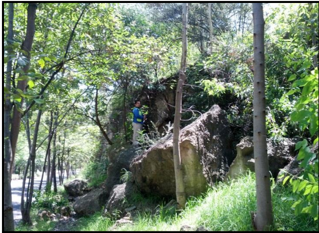
Fotografía 11: se muestra el tamaño de los bloques desprendidos del talud escuela, que invaden la banqueta e impiden el paso peatonal.
