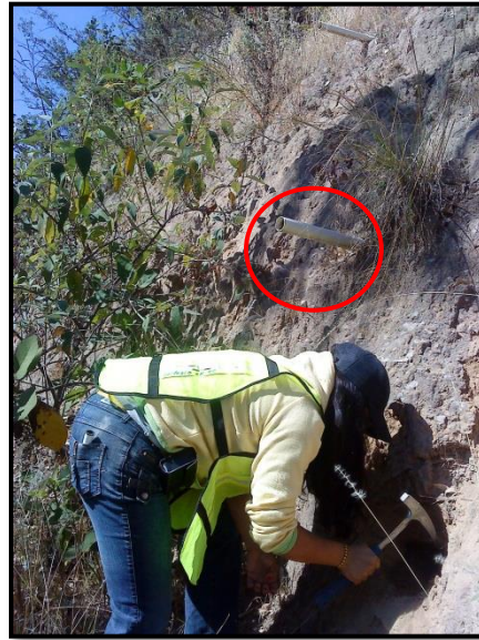
Fotografía 6: se muestran los drenes utilizados para solucionar el problema de humedad que presenta el material de este talud.
