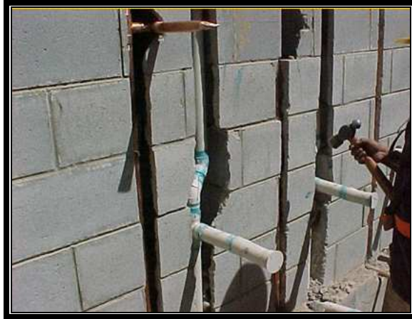
Fig. 2.35 Se deben evitar las perforaciones ya que reducen la resistencia de la mampostería
