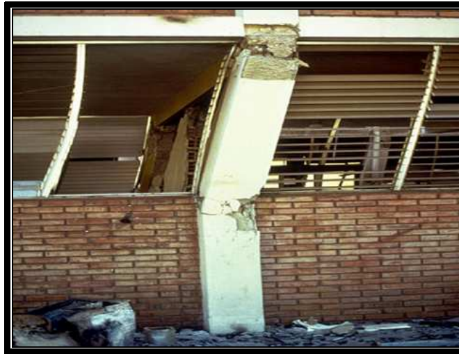
Fig. 2.37 Formación de columna corta por la colocación de un muro ligado a la columna
