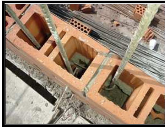
Fig. 2.33 Se debe tener una buena supervisión para que no existan errores constructivos
