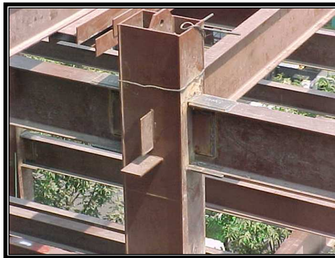
Fig. 2.22 El oxido puede dañar de manera severa las estructuras metálicas
