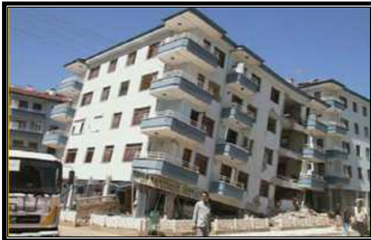
Fig. 2.36 Falta de rigidez debido a entrepiso blando por la colocación de muros de mampostería en niveles superiores
