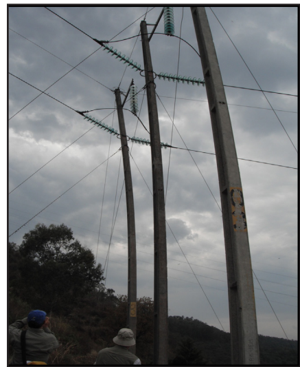
Figura 3.44 Postes deformados como evidencia de la continua actividad de deslizamiento.
