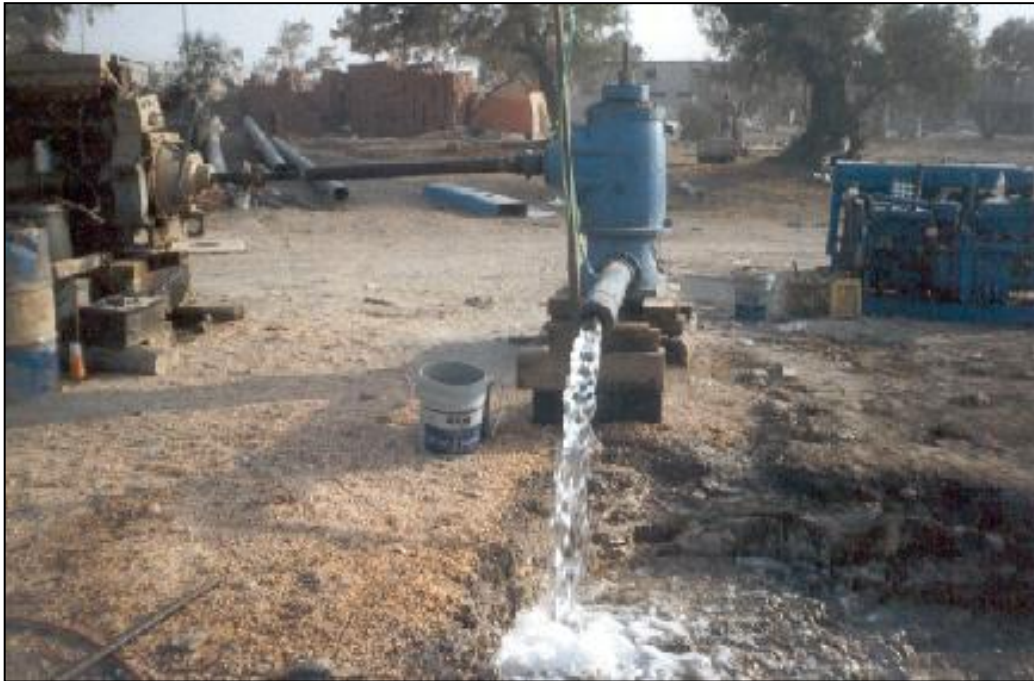
Equipo de aforo con bomba tipo turbina accionada con motor de combustión interna
