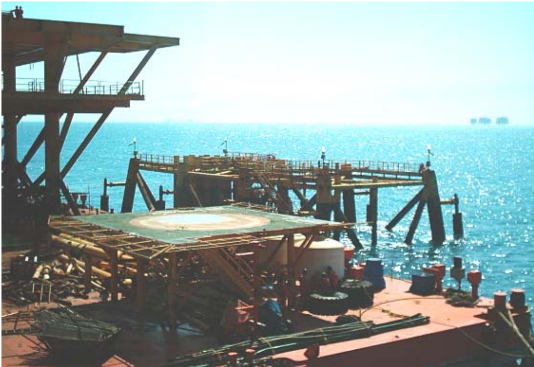
FOTOGRAFÍA 4.56 LOS PILOTES DE LA SUBESTRUCTURA FUERON TAPADOS CON PLACAS CIRCULARES Y EN LAS ESQUINAS SE COLOCARON LAS SEÑALIZACIONES LUMINOSAS DE ACUERDO A PROYECTO PARA DEJAR LA SUBESTRUCTURA ASEGURADA MIENTRAS PEP DECIDE SU FUTURA UTILIZACIÓN.
