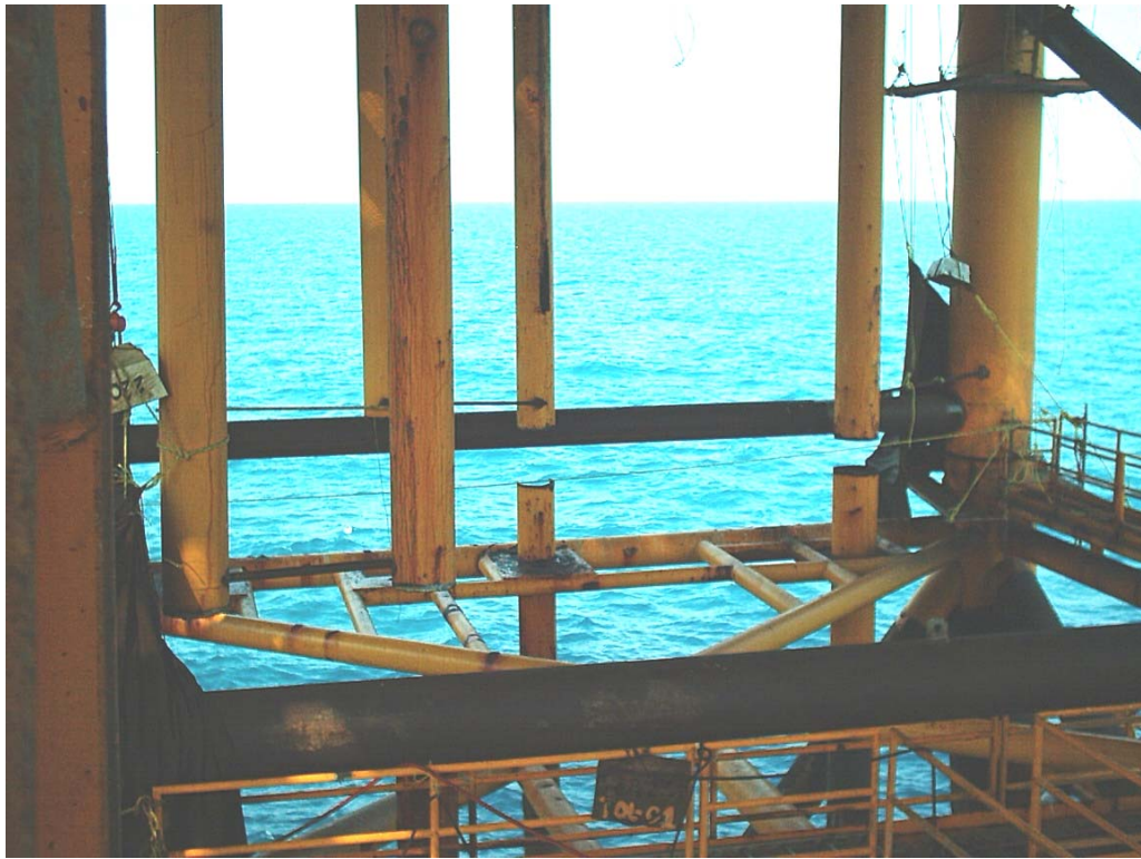
FOTOGRAFÍA 4.6 CORTE DE CAMISAS DE SUCCIÓN DE AGUA DE MAR
