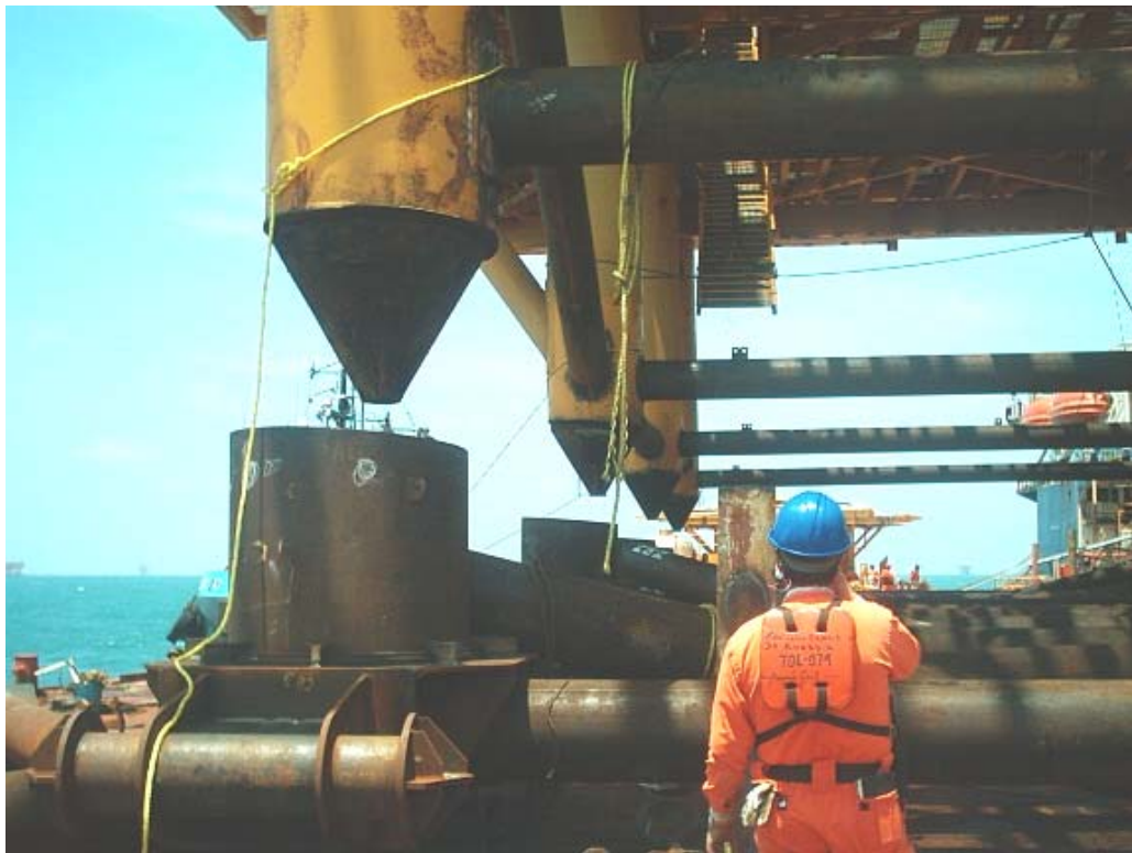
FOTOGRAFÍA 4.50 UNA VEZ REBAJADOS LOS CASQUILLOS DE ESQUINA, SE BAJA LA SUPERESTRUCTURA NUEVAMENTE
