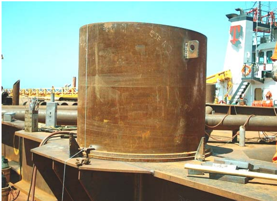
FOTOGRAFÍA 4.31 COLOCACIÓN Y ORIENTACIÓN DE CASQUILLOS PARA RECIBIR A LAS COLUMNAS DE LA SUPERESTRUCTURA
