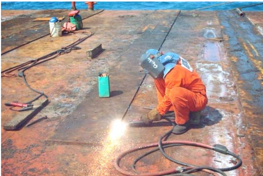
FOTOGRAFÍA 4.23 TRABAJOS DE PREPARACIÓN DE LA CUBIERTA DEL CHALÁN PARA EL ARMADO DEL MARCO
