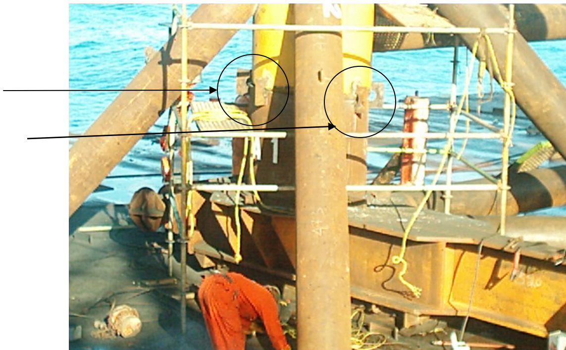
FOTOGRAFÍA 4.54 EN CADA CONEXION PIERNA-CASQUILLO SE COLOCARON OCHO "GRAPAS" DE UNION, DE PLACA DE 1/2" ESP.
