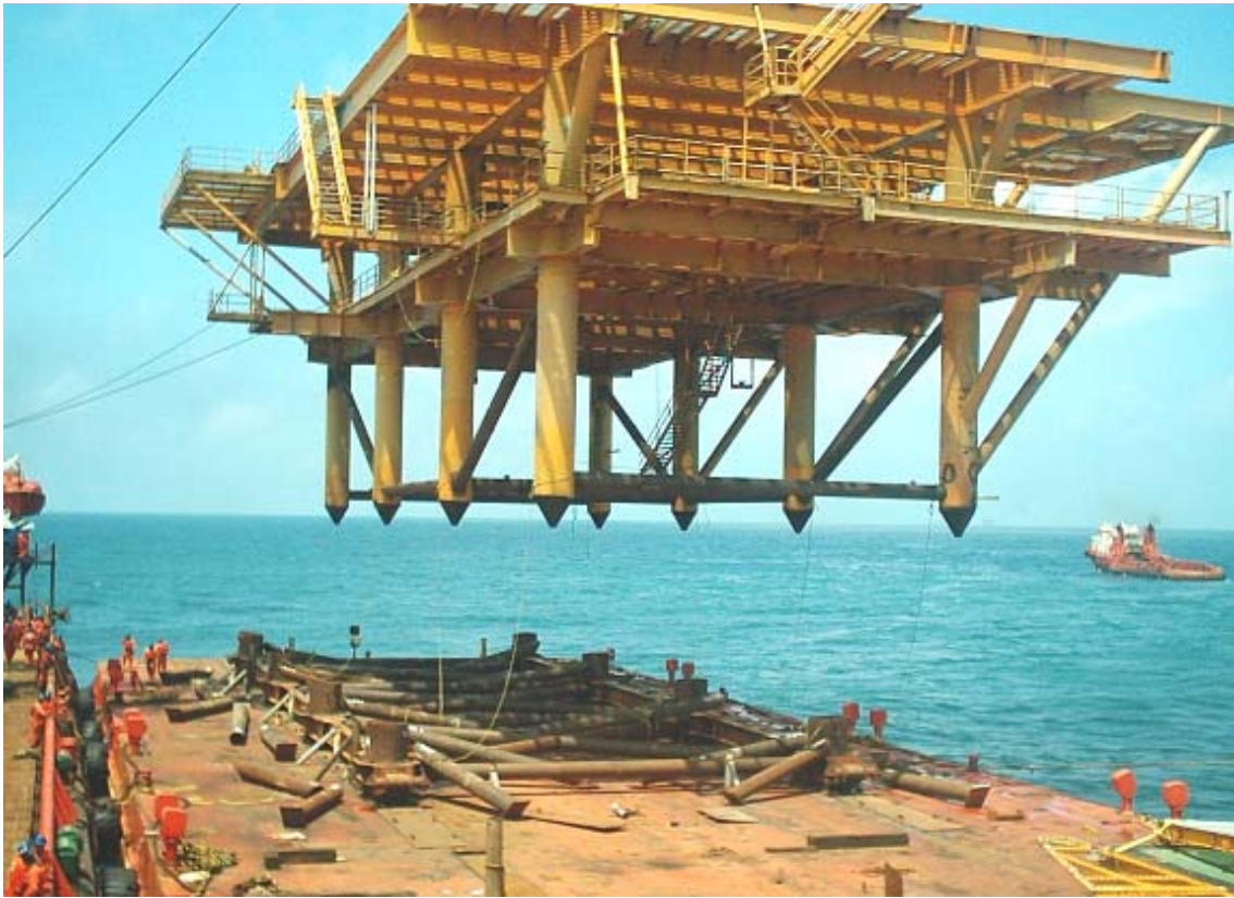
FOTOGRAFÍA 4.45 EL BARCO GRÚA SE POSICIONÓ ALEJADO DEL JACKET, Y EL CHALÁN CON EL MARCO DE APOYO Y ARRASTRE SE COLOCÓ BAJO LA SUPERESTRUCTURA IZADA
