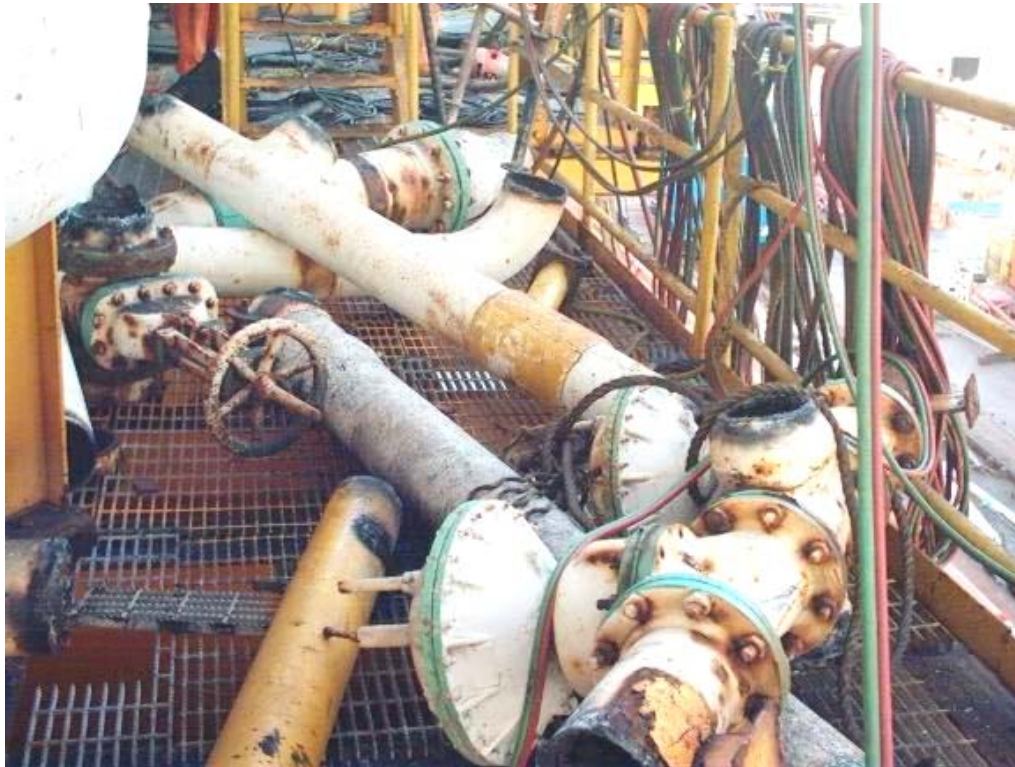
FOTOGRAFÍA 4.4 TUBERÍAS Y VÁLVULAS DESMANTELADAS ANTES DE SER TRASLADAS A LA CUBIERTA DEL B/G TOLTECA
