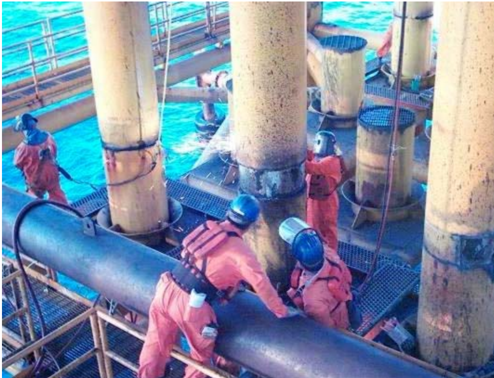
FOTOGRAFÍA 4.11 CAPA CEMENTANTE ENTRE LOS TUBOS DE 30" Y OTRO INTERNO DE 20" DE DIÁMETRO DEL POZO PRODUCTOR
