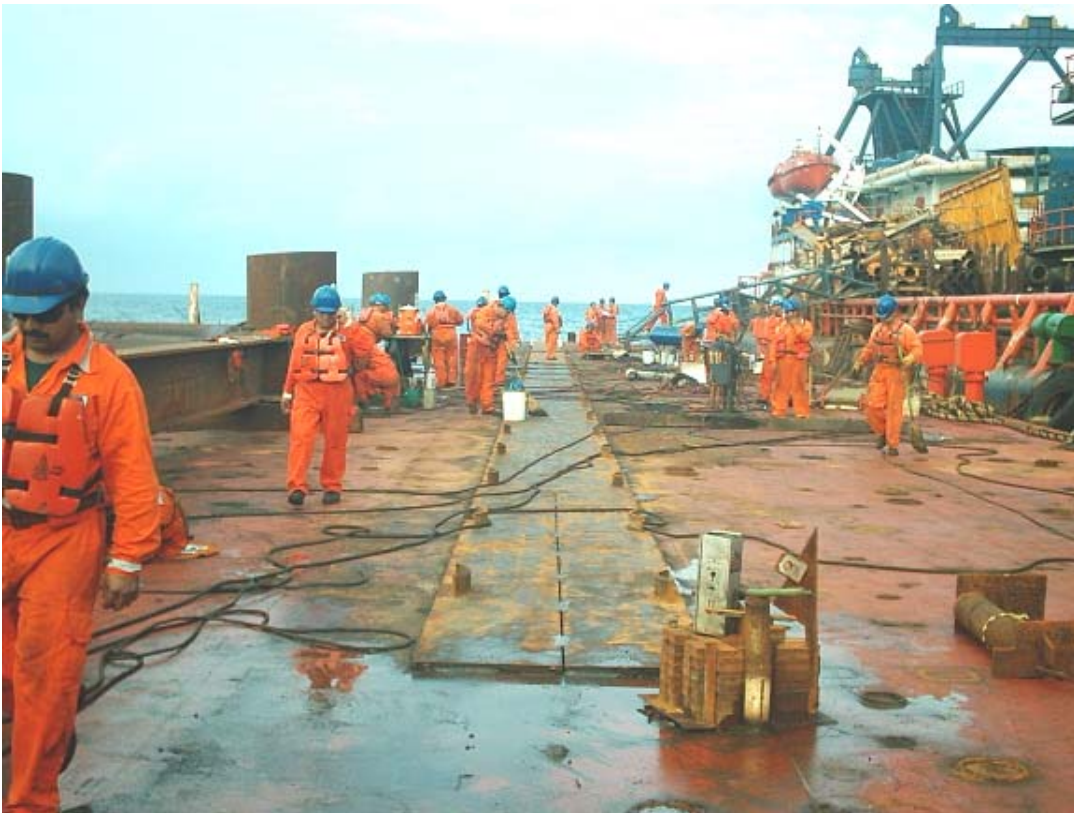
FOTOGRAFÍA 4.33 PLACA Y GUÍAS DE DESLIZAMIENTO PARA ARRASTRE Y DESEMBARQUE EN PATIOS DE TUXPAN, VER.
