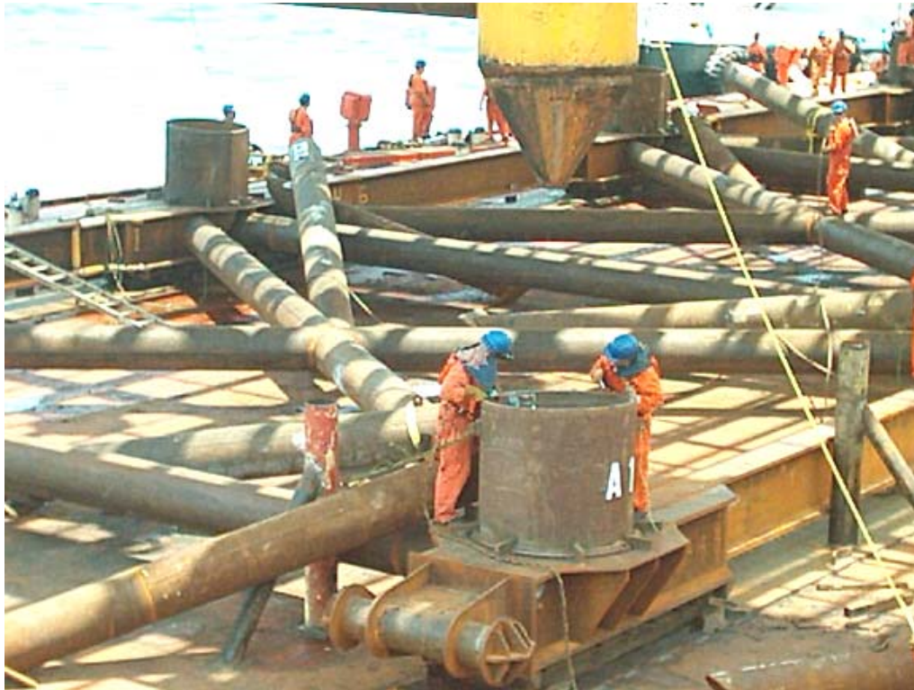
FOTOGRAFÍA 4.49 FUE NECESARIO REBAJAR EL BORDE SUPERIOR DE LOS CASQUILLOS DE ESQUINA, PARA PERMITIR EL ACOPLAMIENTO ADECUADO CON LAS COLUMNAS
