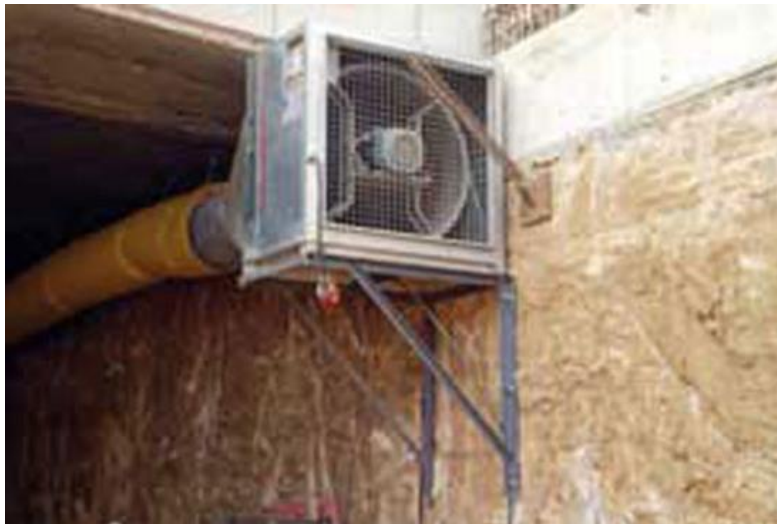
Figura 35. Ventilación en túneles.
