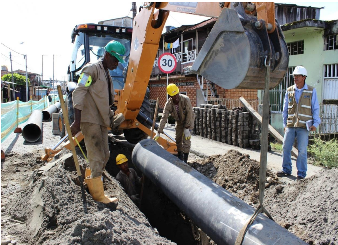
Figura 21. Línea de agua potable secundaria.
