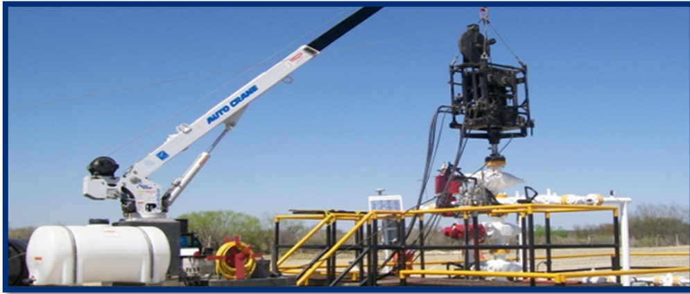
Figura 18. Equipo de tubería capilar
