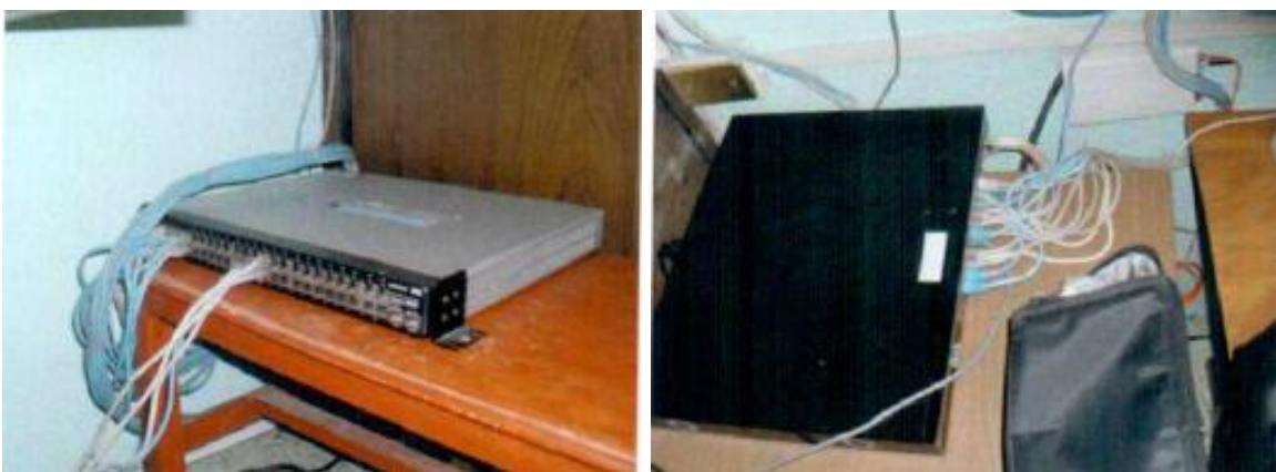
Figuras 6.1.8.38 y 6.1.8.39 Switches Enterasys localizados en la Primaria
