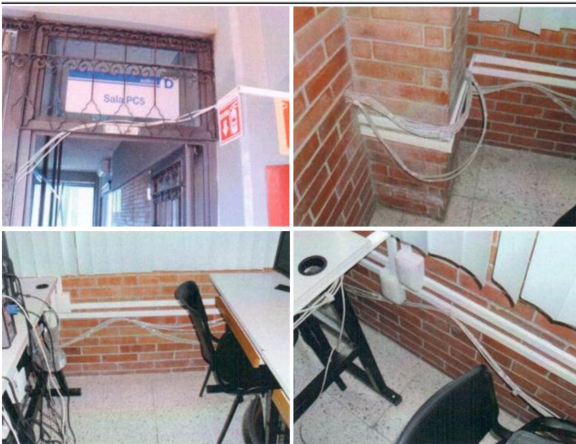
Figuras 6.1.8.16; 6.1.8.17; 6.1.8.18 y 6.1.8.19 Cableado Sala PC5
