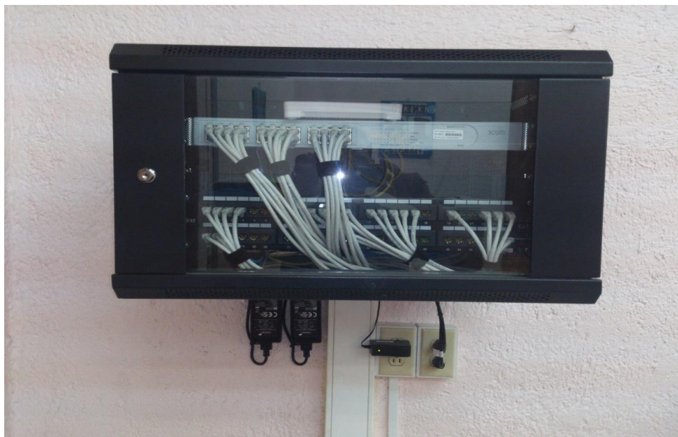
Figura 6.4.10 Gabinete localizado en Biblioteca
