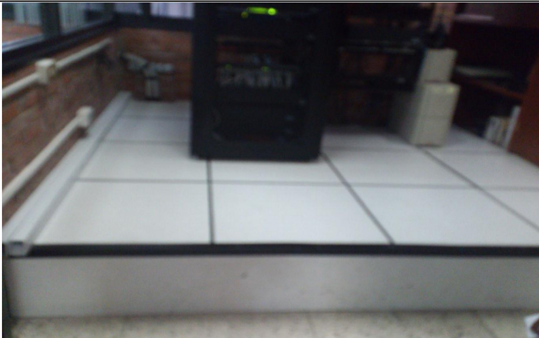
Figura 6.4.3 Piso falso del Site de CTI
