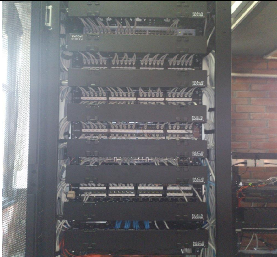
Figura 6.4.1 Rack de Comunicaciones localizado en CTI
