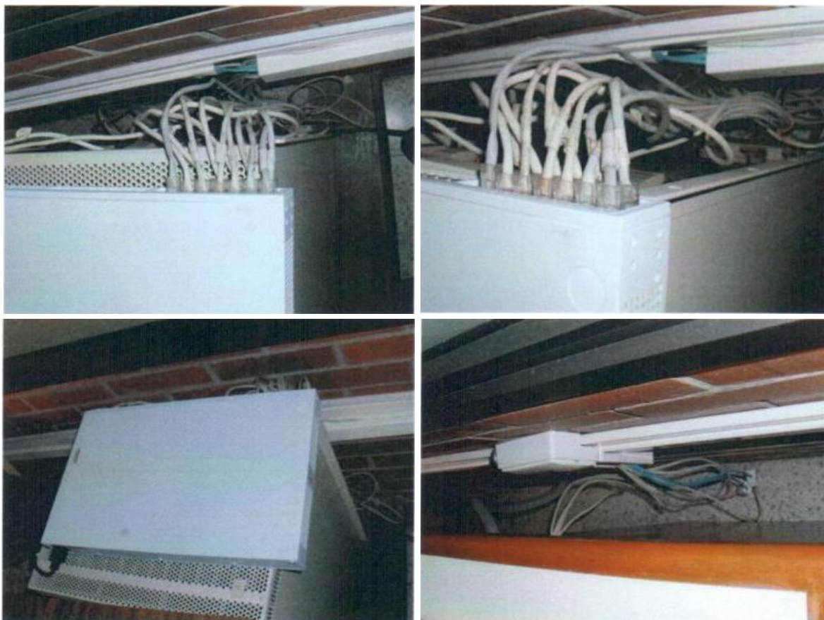
Figuras 6.1.8.12; 6.1.8.13; 6.1.8.14 y 6.1.8.15 Switch 3com localizado en PC4
