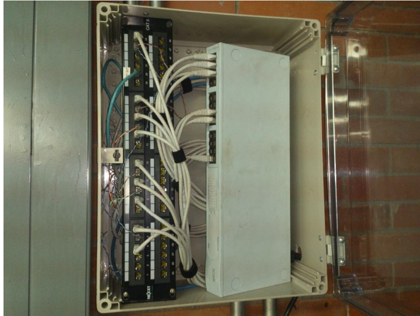
Figura 6.4.5 Gabinete instalado en planta piloto
