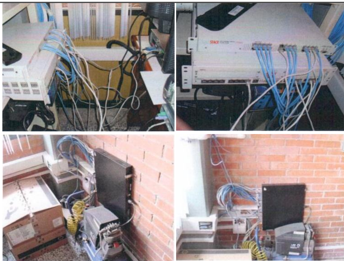
Figuras 6.1.8.8; 6.1.8.9; 6.1.8.10 y 6.1.8.11 Switches y cableado de Sala PC3
