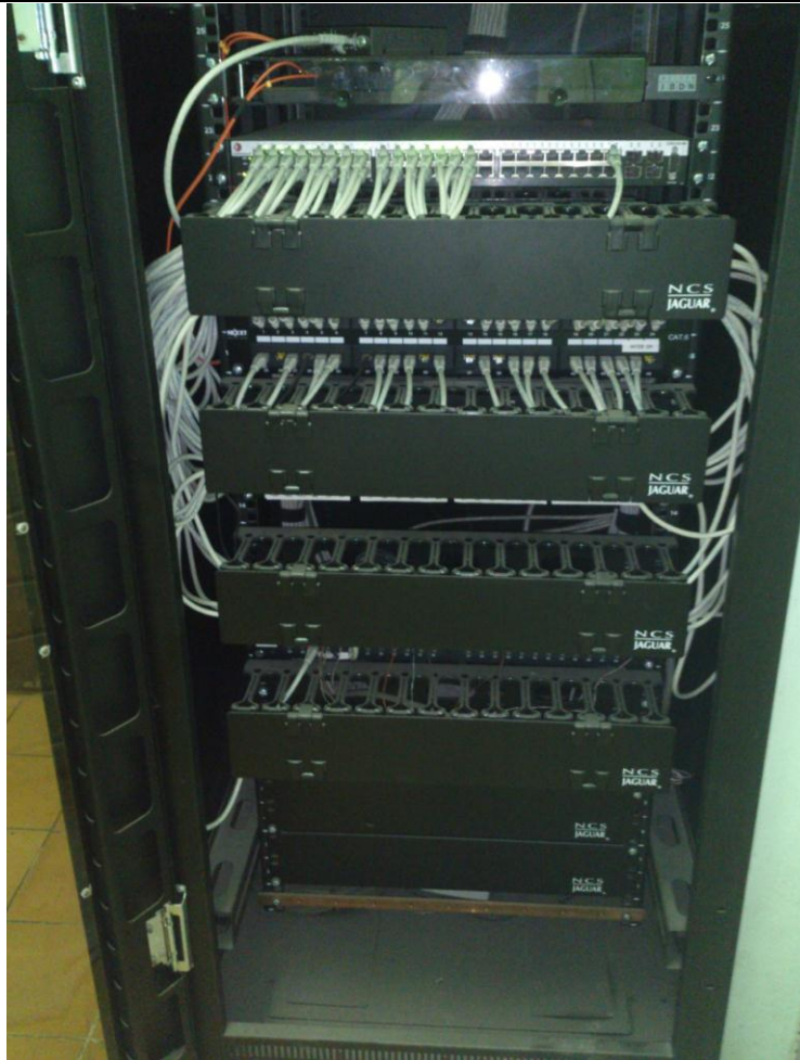
Figura 6.4.12 Rack de Comunicaciones de Rectoría
