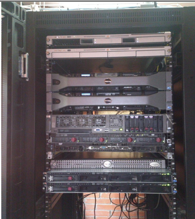
Figura 6.4.8 Servidores instalados en el Rack de RDI
