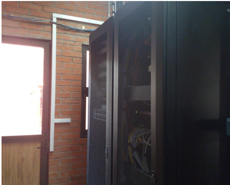
Figura 6.4.6 Gabinetes instalados en el Site de RDI
