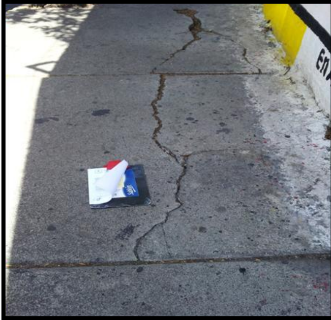
Foto 5.7. Fractura ubicada en el retorno de calzada Minas de Arena, en dirección R. del Monte esquina calle 4ª.
