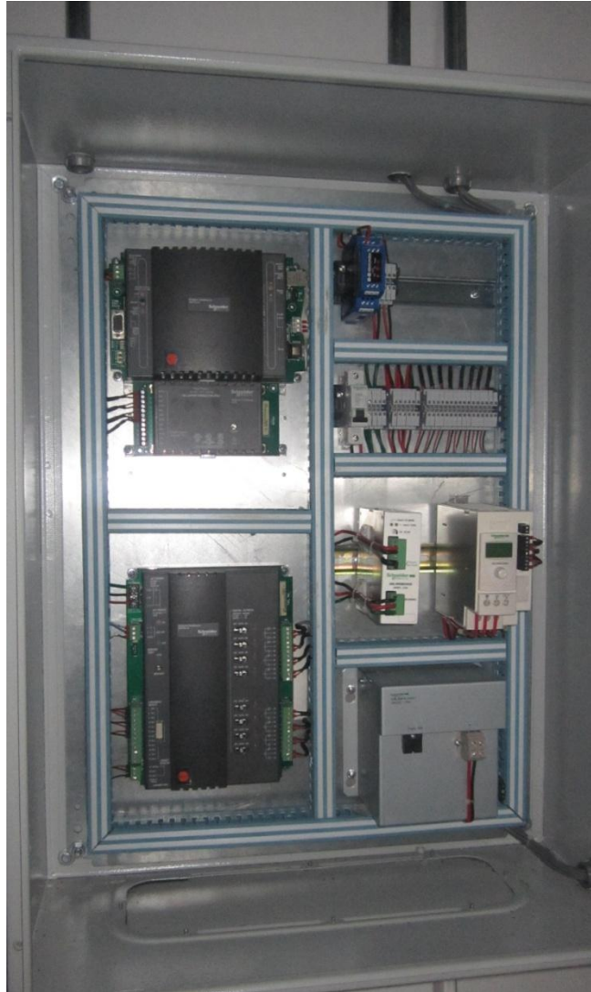
Fig. 4.4.1. Tablero de control de temperatura de un cuarto de IDF
