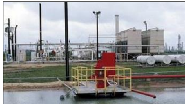
Figura 1. 12 Planta geotermoelectrica en Texas alimentada de un yacimiento geo-presurizado.
