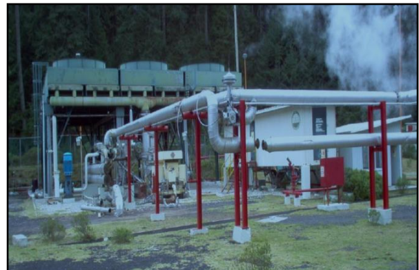
Figura 1. 18 Unidad de ciclo binario campo geotérmico los Azufres, Michoacán.
