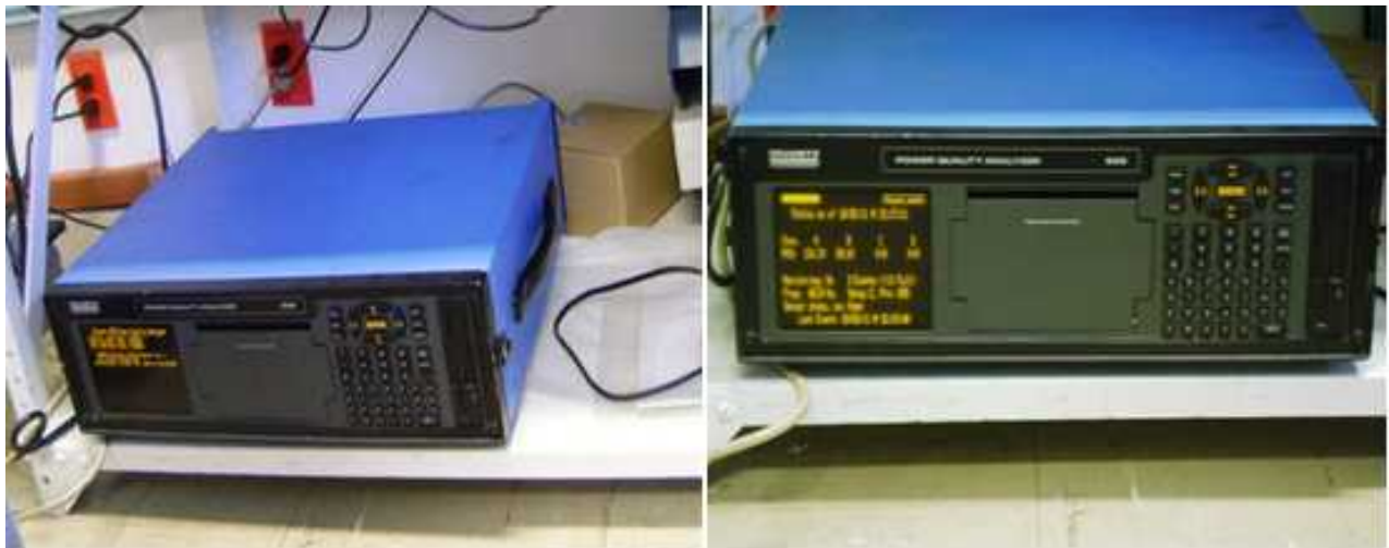
Figura 54. Dispositivo requerido para el monitoreo de la red eléctrica Dranetz-658
