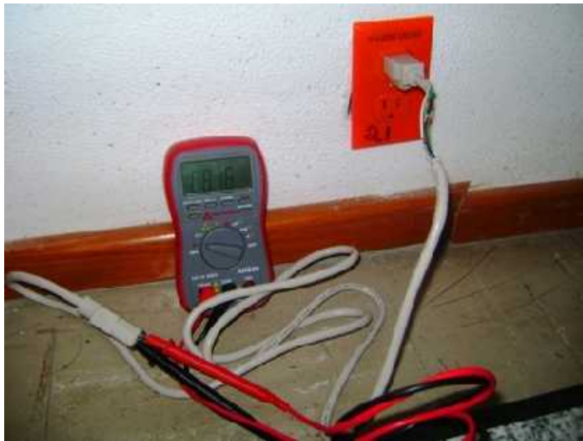
Figura 51. Medición del voltaje en la terminal de nuestro cable de alimentación del equipo de cómputo
