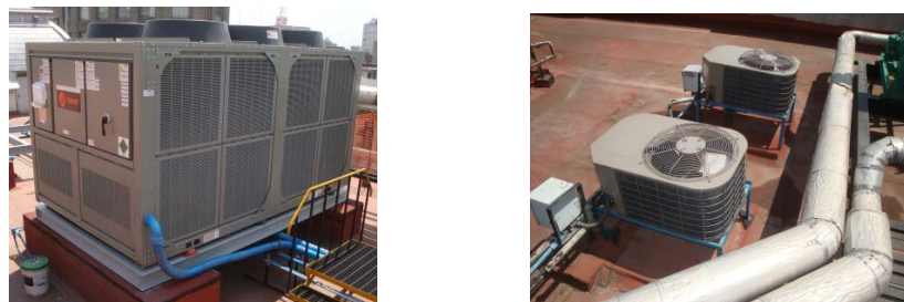
Figura 3.18 - Equipo de aire acondicionado.
