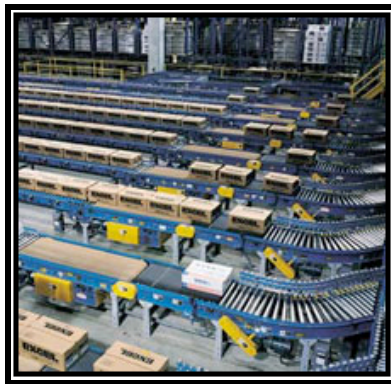
Fig. 9 Sistema de transportadores
