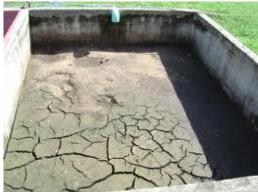
Figura 3.1.- Lodo residual, planta de tratamiento.
