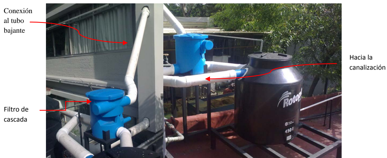
Figura 68. Filtro de cascada VF-1 (izquierda). Tinaco Rotoplas (derecha).
