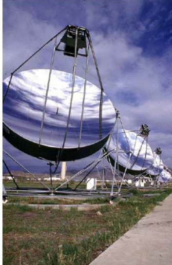
Figura 49. Colector solar de alta concentración. (PSA, España).
