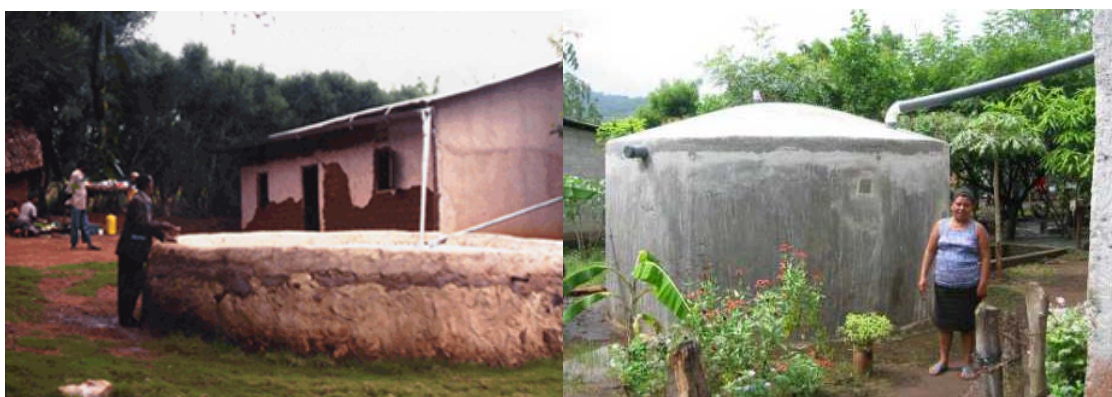
Figura 15. Sistemas de captación de agua de lluvia en techos de lámina, conducción y almacenamiento. Nicaragua.
