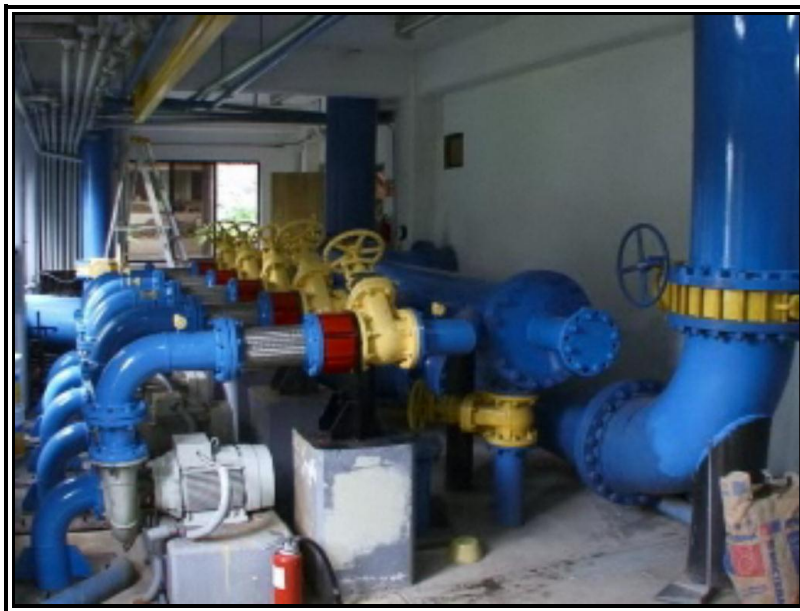
Figura 28. Cuarto de máquinas.
