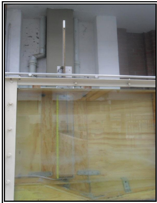
Figura 51. Limnómetro ubicado en la garganta del Parshall.
