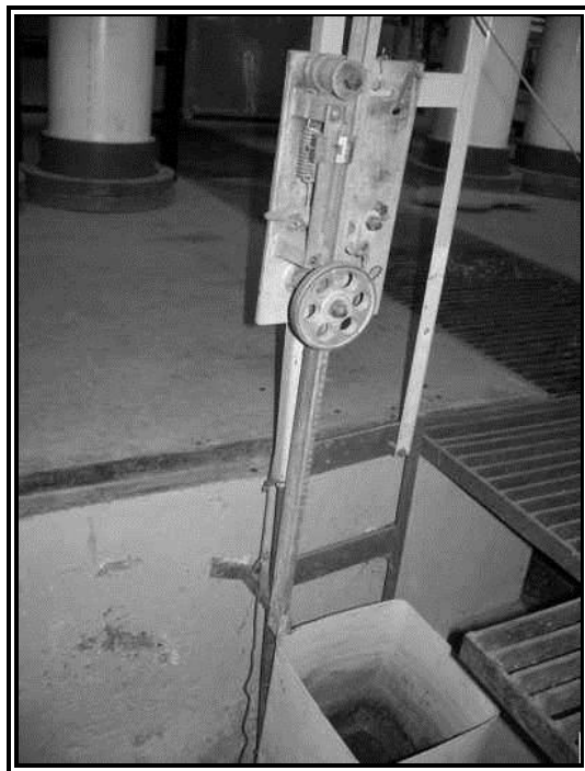
Figura 10. Limnómetro para leer la carga sobre el vertedor Rehbock.
