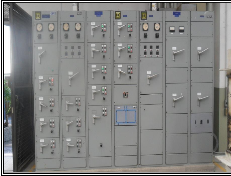
Figura 45. Caseta de control de bombas.
