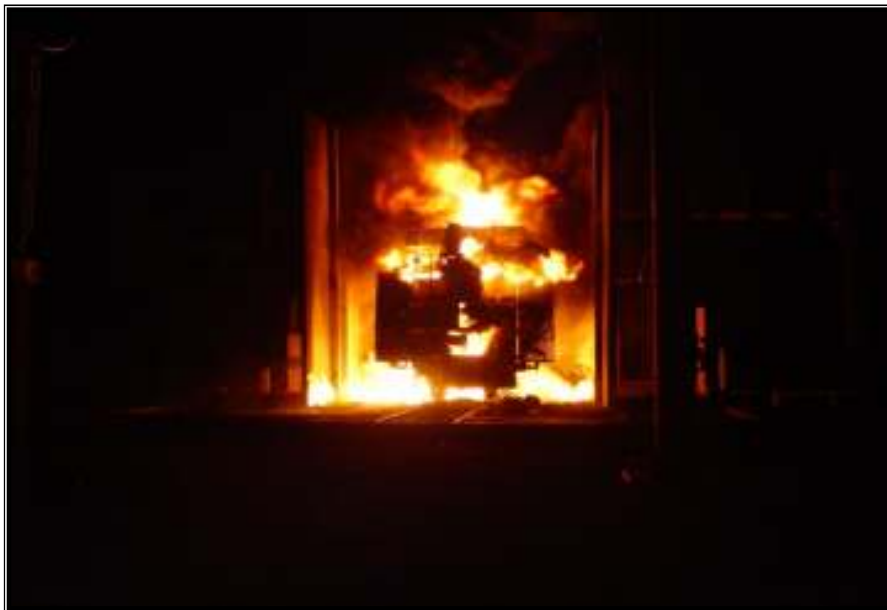
Figura 2-10. Transformador de potencia en llamas debido a una falla no librada.
