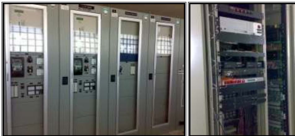
Figura 2-5. Tableros de Protecciones y Control Supervisorio
