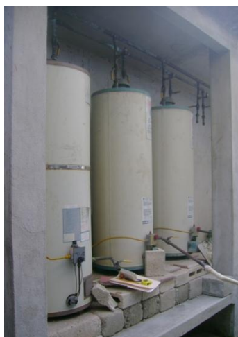
Figura 11: Boilers encontrados en el Hotel Colonial Los Arcos de Ciudad del Carmen Campeche
