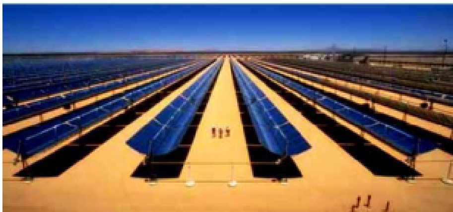
Figura 23. Campo Solar de paneles parabólicos.
