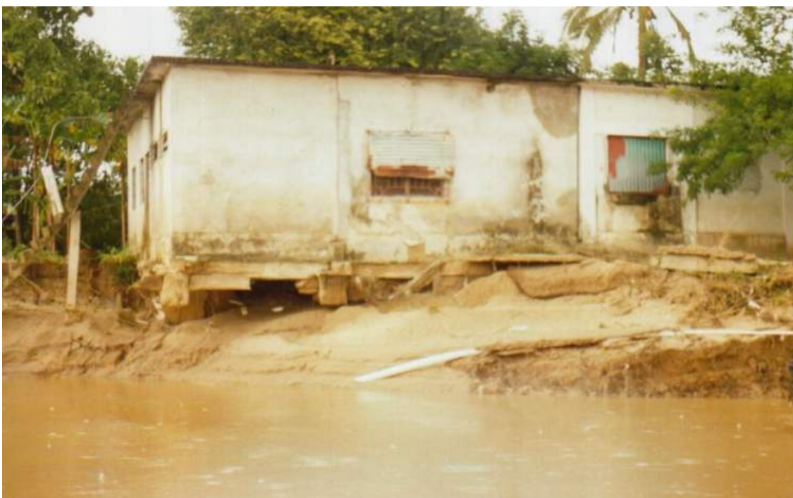
Figura 4.2 Socavación en casa - habitación
