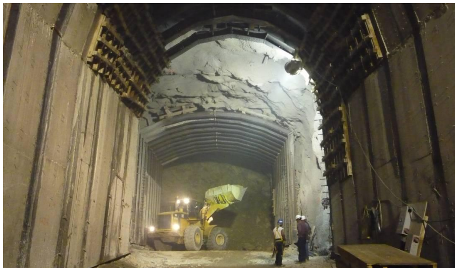
Figura 2.57.- Cargador frontal CAT 966, utilizado en el proceso de retiro de material para la construcción de la bóveda de la galería de oscilación.
