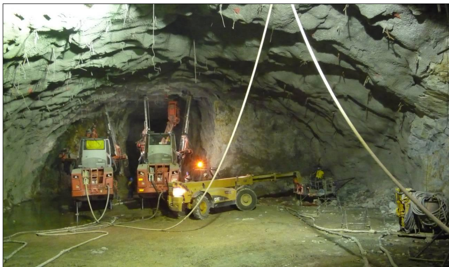
Figura 2.53.- Equipo utilizado en el proceso de excavación de banqueros y fosos de turbina.
