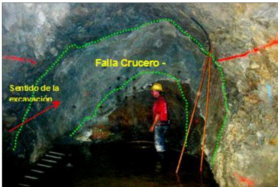
Figura 2.14.- Aspecto de la falla Crucero-Pitayo en el cadenamamiento 0+024,0 m del crucero 0+290,6 izquierdo del socavón 04 MD.
