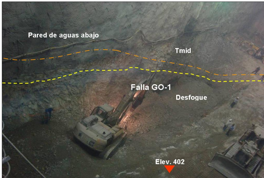
Figura 2.109.- Vista de la falla GO-1 que va desde la pared de aguas abajo hasta la pared de aguas arriba de manera diagonal a la galería de oscilación.
