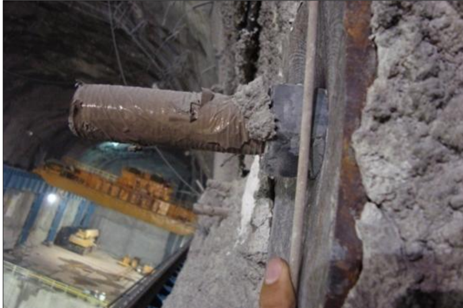
Figura 2.83.- Deformación en las placas de reparto del anclaje.
