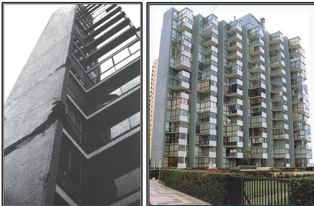
Figuras 3.7 y 3.8: Daños en Edificio Acapulco y en la actualidad, Viña del Mar, Chile.
