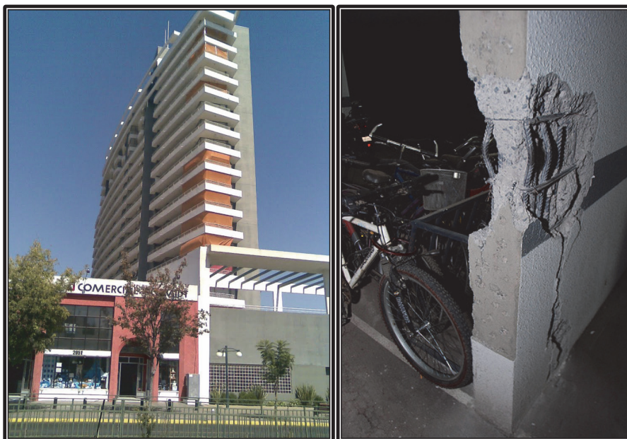
Figura 3.26 y 3.27: Edificio Emerald (antes y después del terremoto de 2010), Ñuñoa, Santiago, Chile.
