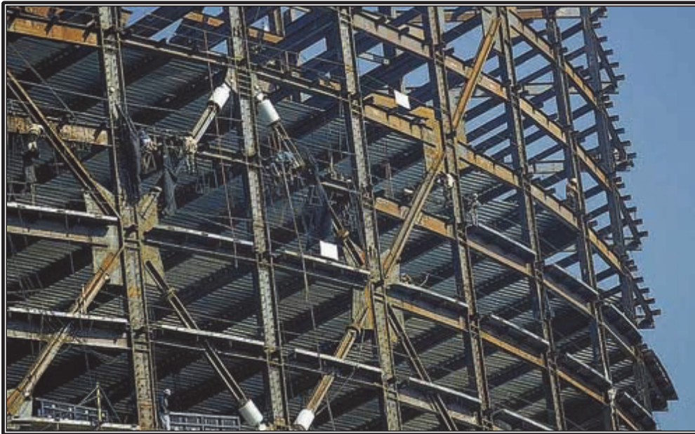
Figura 2.85: Amortiguadores sísmicos de la Torre Mayor, México, DF.
