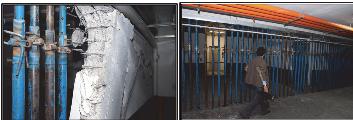
Figura 3.28 y 3.29: Edificio Emerald, Ñuñoa, Santiago, Chile. Daños en el subterráneo.
