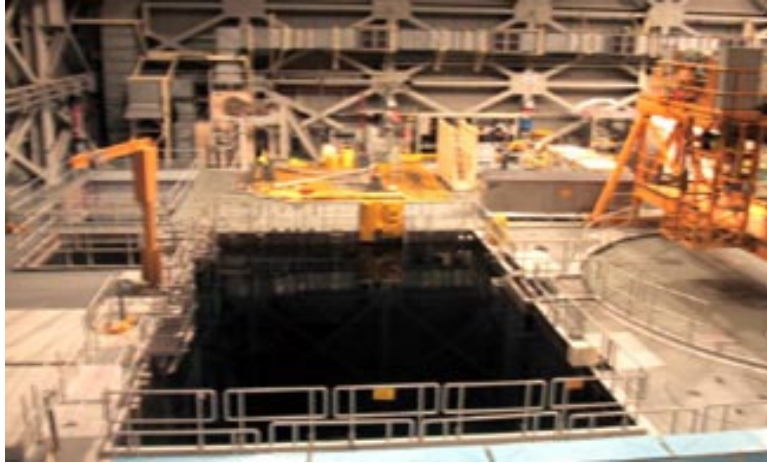
Figura 4.13 Alberca para Combustible Gastado (ACG) [Fuente: CFE, 2008a]
