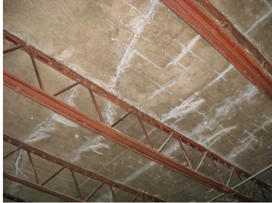
Figura 3.7 Sistema de grietas en una losa de la planta baja
