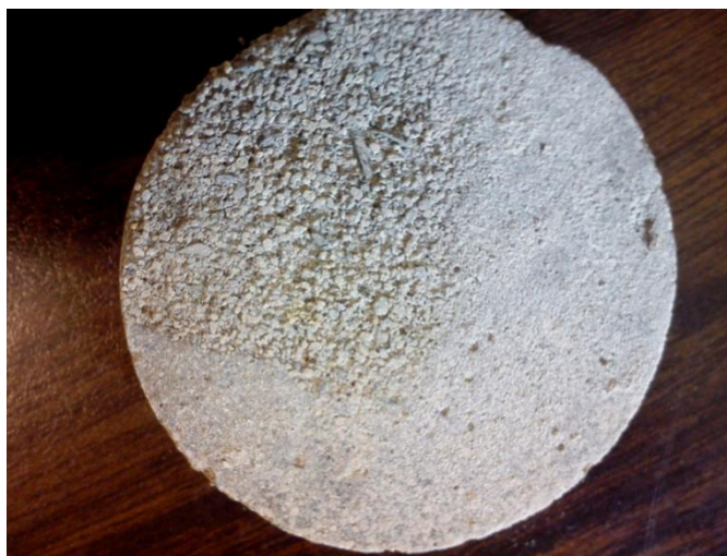
Figura 6.33 Erosión después de 10 años.
