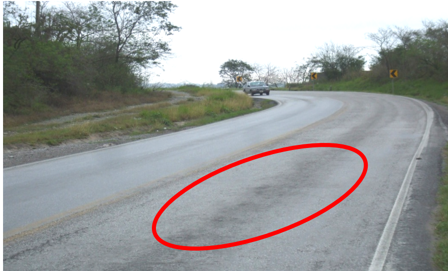
Figura 5.14. Vista general un poco adelante del kilómetro 32+700, se aprecia el desprendimiento de la carpeta asfáltica.
