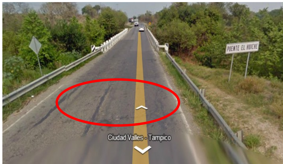
Figura 5.13. Vista general antes de llegar al kilómetro 32+700, se aprecia el desprendimiento de la carpeta asfáltica.
