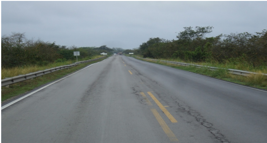
Figura 5.10. Muestra el tipo de terreno sensiblemente plano con fisuras y ondulaciones sobre el pavimento, así como la cobertura vegetal (pastizal) en el kilómetro 32+280.
