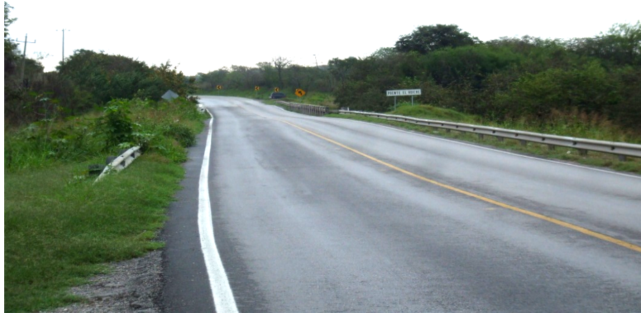
Figura 5.12. Vista general del tramo en estudio del kilómetro 32+440 hacia adelante. Se aprecia el señalamiento en buen estado y ondulaciones del pavimento.
