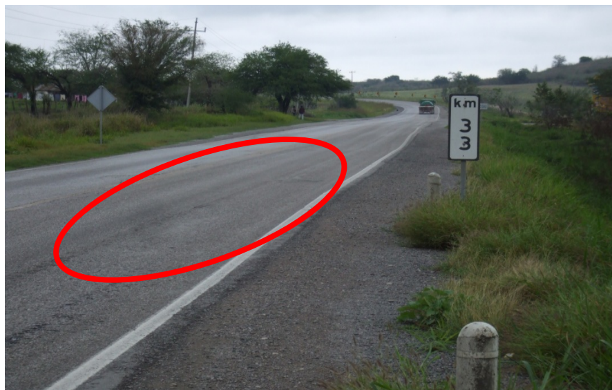
Figura 5.15. Vista general del kilómetro 33+000 donde se aprecian ondulaciones y fisuras sobre la superficie de rodamiento.
