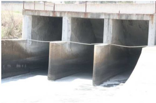
Fig. 2.8 Túnel alcantarilla bajo el río el Salto
