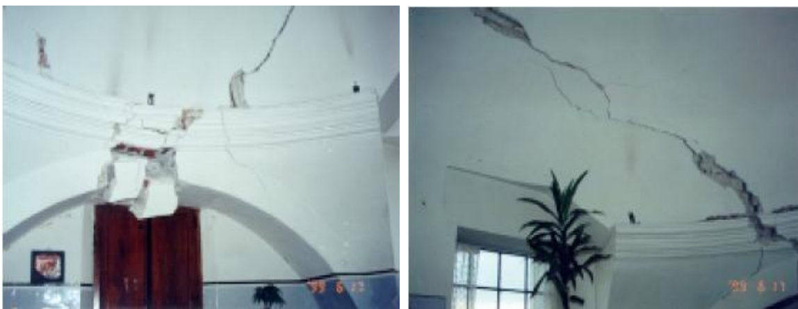
Figuras 4 y 5. Daños ocasionados durante el sismo de Tehuacán en el edificio Carolino (ref 8)
