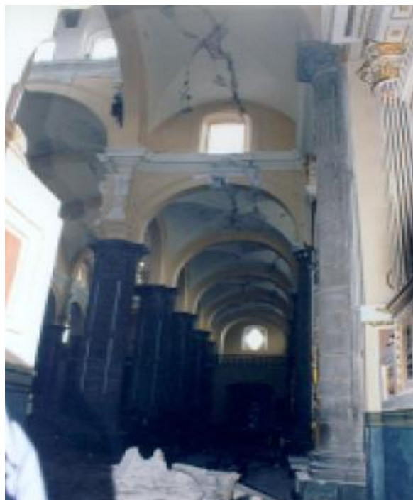
Figura 3. Daños en la iglesia de la Compañía (ref 7)
