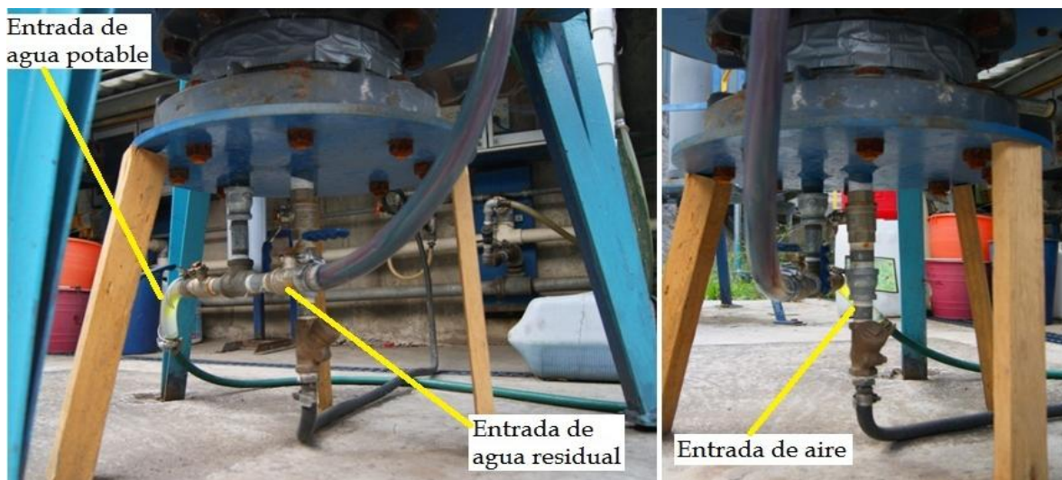
Figura 3.8. Detalle de la parte inferior de los filtros.
