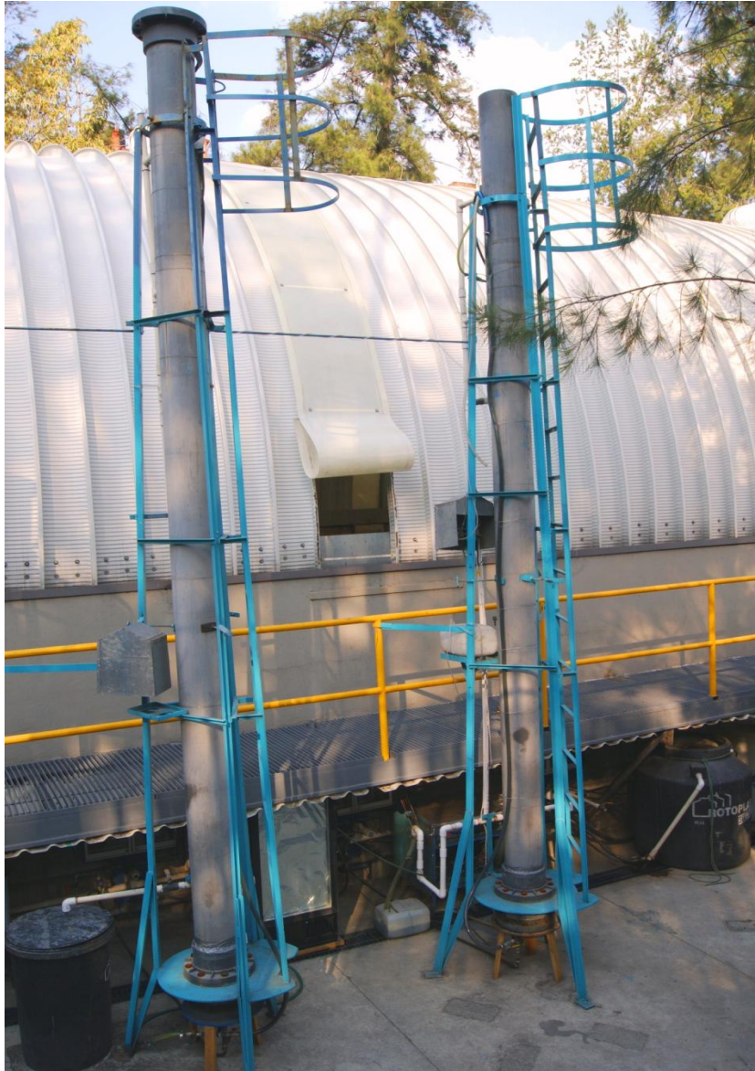
Figura 3.3. Vista general de los filtros piloto instalados en la PTAR de CU.
