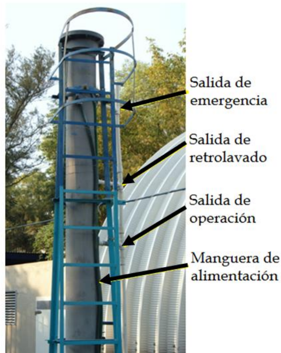
Figura 3.6. Vista de la parte superior de los filtros.
