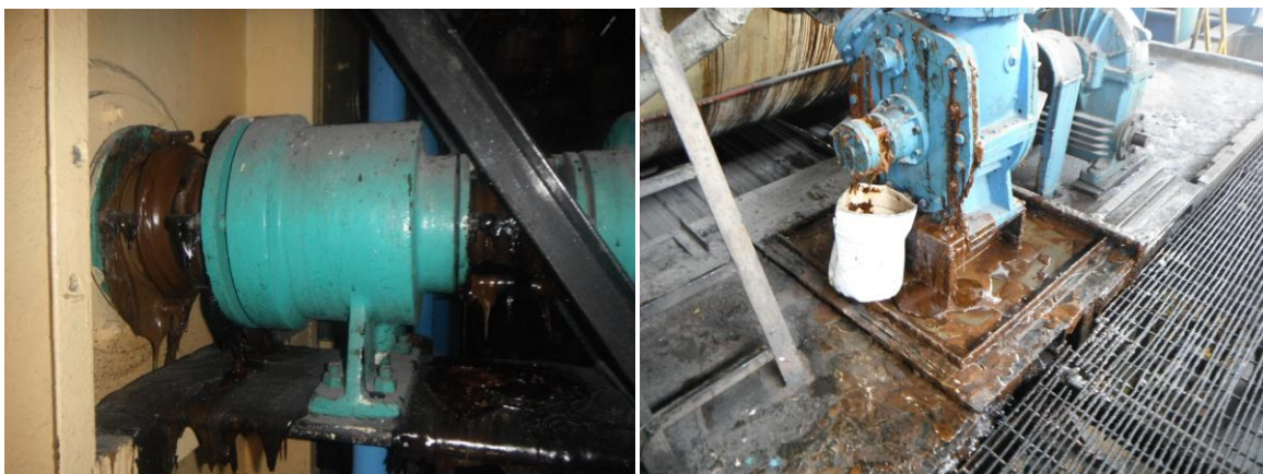
Figura 4.38 Fugas y derrames en el departamento de cristalización y centrifugación.
