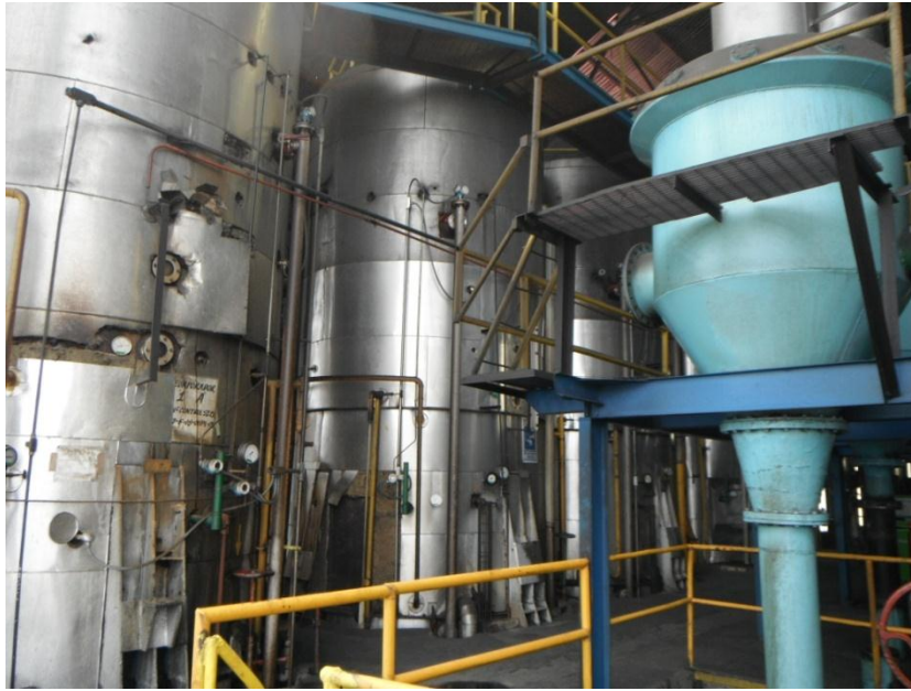
Figura 4.35 Evapores de cuádruple efecto y condensadores barométricos.
