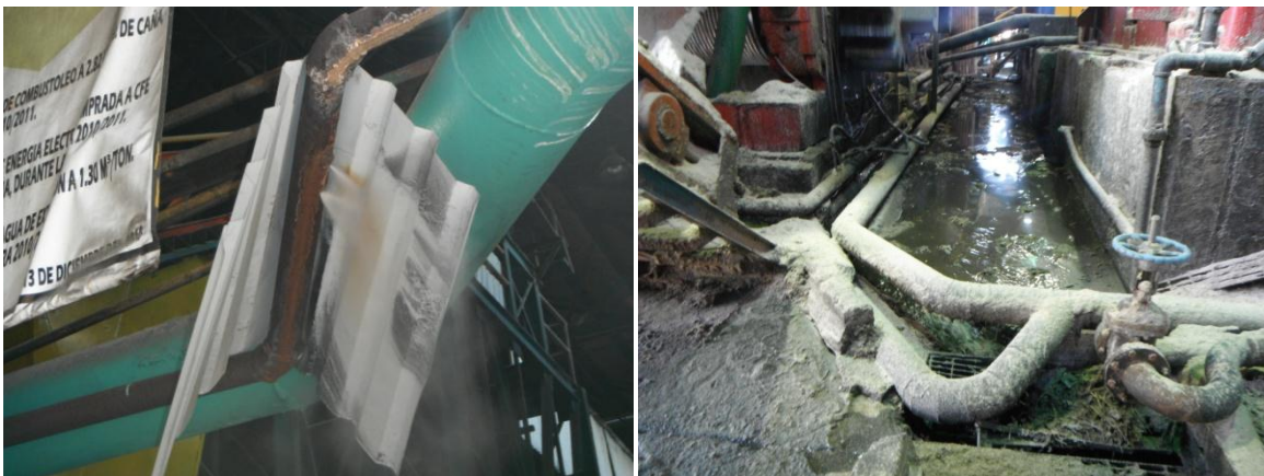
Figura 4.19 Fugas y derrames en el departamento de molinos.
